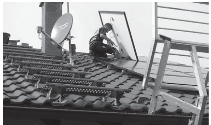
Drei Montageteams bringen die PV-Module auf den Dächern in Aichwald und Lichtenwald an. (Foto: Pusch)
